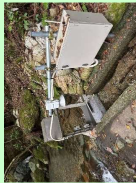
水位監視システム
