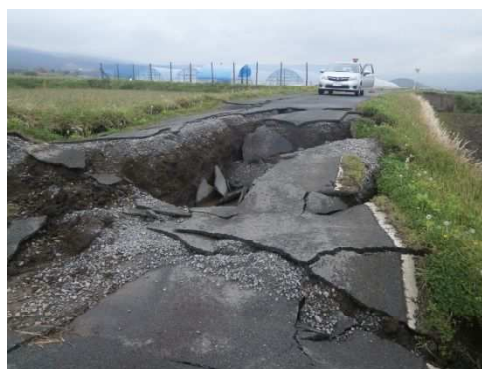
通行不能となった農道
