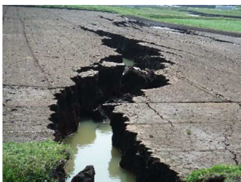
農地を切裂く大きな亀裂
