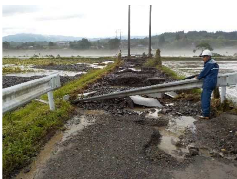
被災した農業用道路
