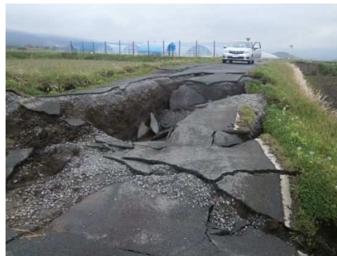
通行不能となった農道
