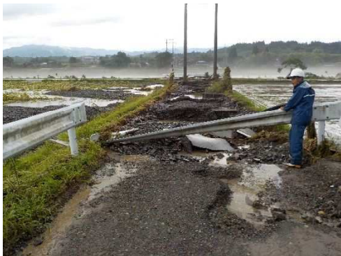
被災した農業用道路
